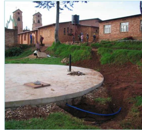
Dachfläche der Kathedrale liefert über Vorfilter Regenwasser in die unterirdische Zisterne. Eingetauchte Solarpumpe pumpt über blaue Wasserleitung Regenwasser in Hochbehälter.
