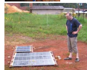
Solarpanele für die Pumpe und UV Anlage
